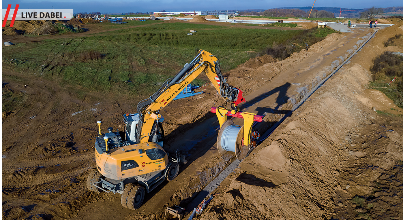
Der offensichtliche Vorteil des KabelFIX: Der Bagger rollt die Trommel direkt über dem Graben ab. Das Kabel liegt sofort dort, wo es hingehört.
